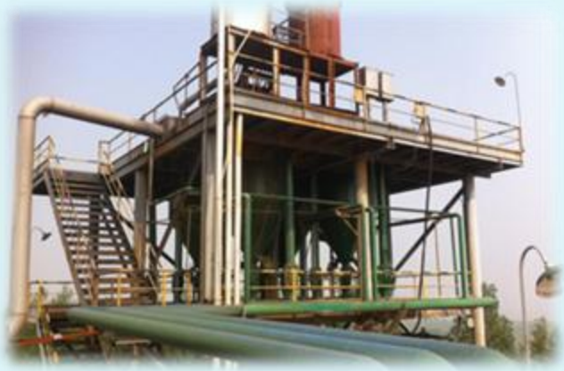
洛宁紫金废水处理系统
