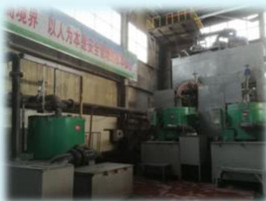
改造后的破碎工段除尘系统
